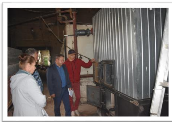
Фото 23. Новые котлы в с. Покровское
