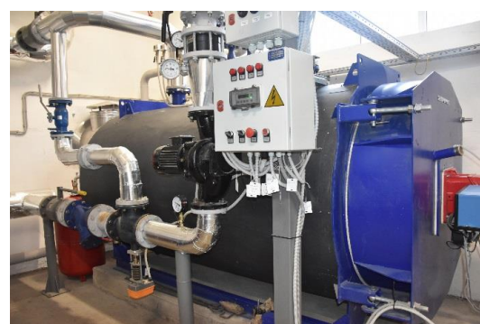
Фото 27. Новый котел мкр Агропромхимия в п. Сазоново
