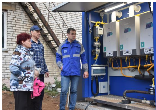
Фото 28. Оборудование и подключение тепло-генерирующей установки
